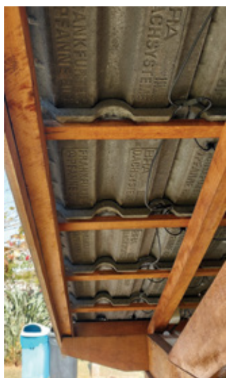
Conexão Paralelo Negativo – Lado esquerdo do telhado (Vista Frontal Inferior)
